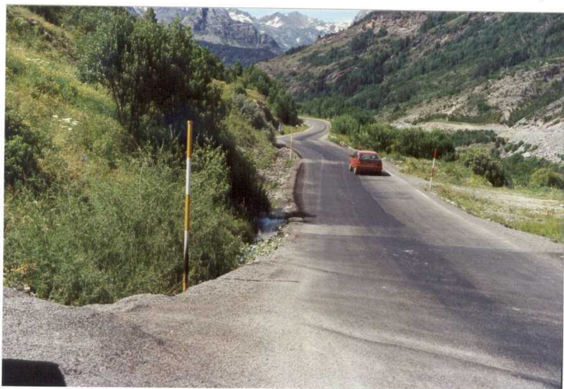
Fotografías 5 y 6 .: Desplazamiento relativo producido por el deslizamiento (arriba). Obsérvese en ambas el manantial que queda represado por la cuneta de la izquierda, donde a su vez se filtra por debajo de la calzada.
